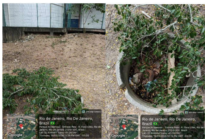
Figura 7 – Registros das visitas técnicas realizadas no parque: (a, b) tubulação de efluente sem vedação e com resíduos acumulados.
